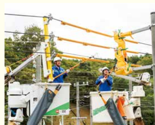
写真左側のYE303を取り付けた高所作業車は、電線を支持するのみ。バケットが電柱から遠い
