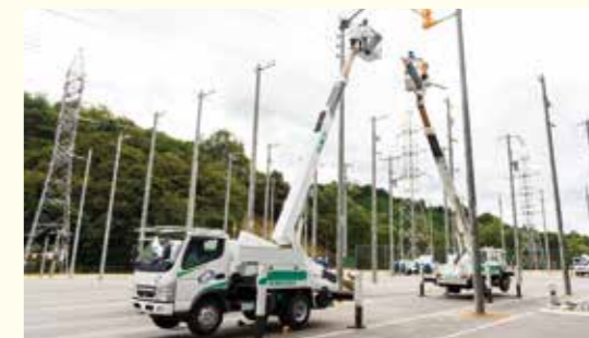
高圧ピン碍子から電線荷重を外し、さらに巻付バンドを外して仮腕木を上昇、ウインチ起伏で電線を遠ざける
