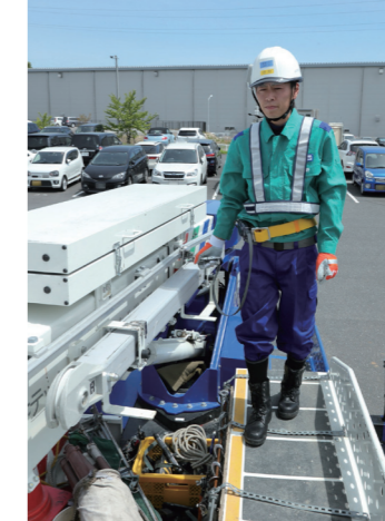
安全器をアシストレールに沿わせながら架装部上を移動する。
