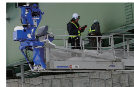
点検作業が効率的に行える歩廊式プラットフォーム
