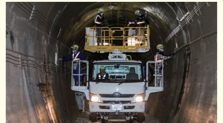
トンネル点検モード
