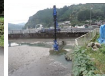
橋の上部に並走する電線を乗り越えての作業。最大乗り越え高さ6mのブームが活躍
