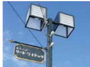
「リード・ライテック」と社名を掲げたオリジナル街路灯。これも景観照明のひとつだ
