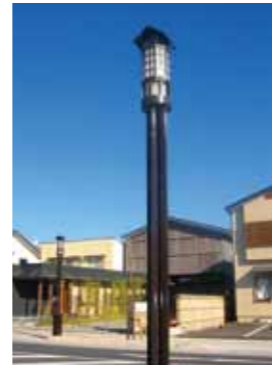
同社が手掛けた施工例その1 (宮城県岩出山町南町商店街)
