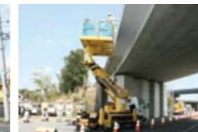
高架下だけでなく高欄(こうらん)部分の打音点検も行う
