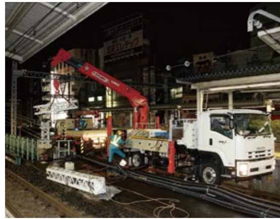
トロリ線やブームを巧みにかわしながら撤去物を搬送車に積込むU650。自車のキャビンが邪魔にならない後部架装クレーンの稼働域の広さが特長だ
