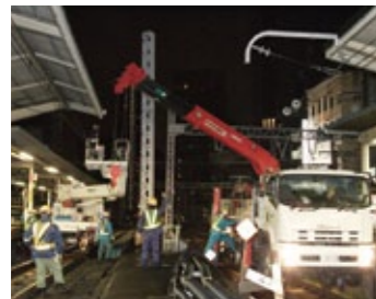
ホームとホームの構造物に挟まれた障害物が多い場所でも滑らかな動きを見せるU650
