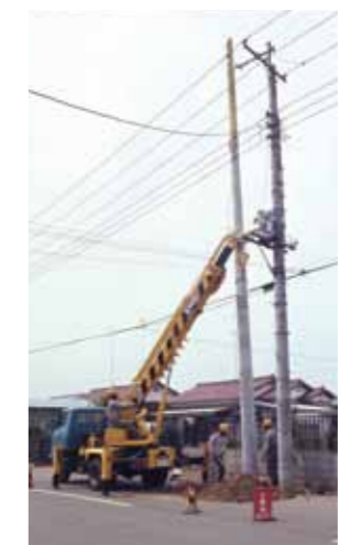
D400E型 穴掘建柱車 1971(昭和46)年 電気・通信工事業界で穴掘建柱車の導入が進みました
