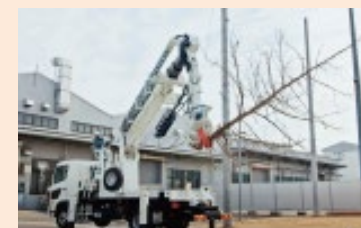
架空線へのかかり木や倒木の除去に対応できる作業車
